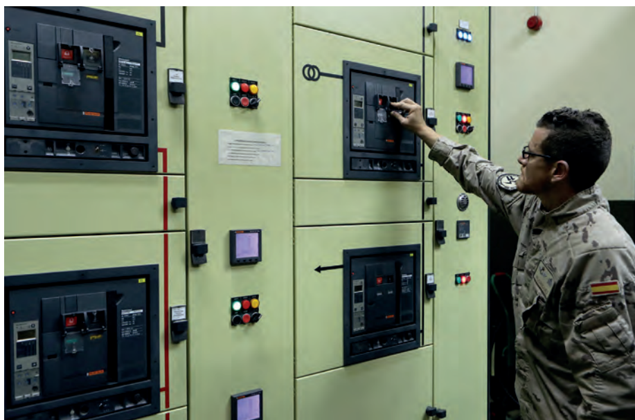
Los equipos de la sala SAI (Sistema de Alimentación Ininterrumpida) controlan la energía que llega al radar para evitar averías.
