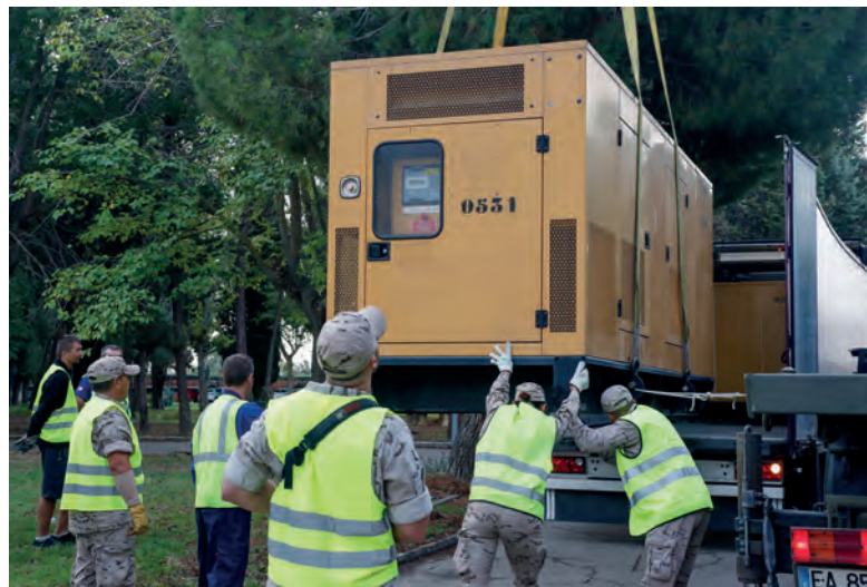
Preparación del convoy que trasladó vía terrestre los cuatro grupos electrógenos donados por España para paliar la falta de electricidad que sufre la población ucraniana.
